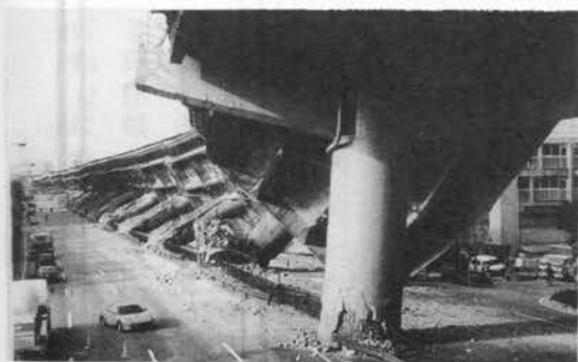
上:空前の被害がでた (毎日新聞編『阪神大震災』より)
